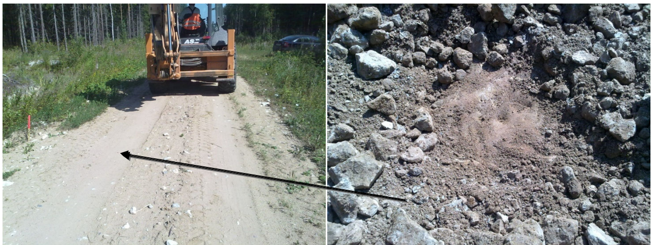
Foto 43 ja 44. Kolmas Udriku tee surf võetuna lõigu keskelt. Materjal tundus suhteliselt savine; geotekstiil oli laitmatus korras. Siit võeti kolmas pinnaseproov
