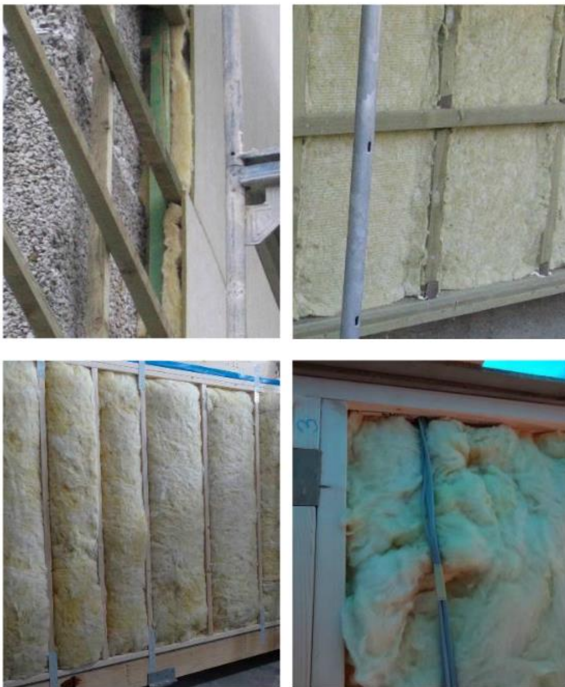
Joonis 4.9 — Lubamatud soojustuse paigalduse vead, kui soojustus ei täida kogu talle ettenähtud ruumi
